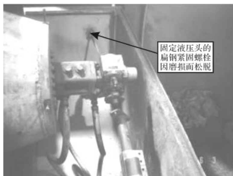
图2 紧固螺栓松脱后的液压头固定扁钢
